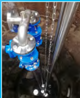
Vystrojení přečerpávací stanice pod zámek
